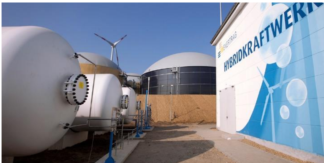
Bild 3: Wasserstoffspeicher des Projektes HYDROSOL 2
